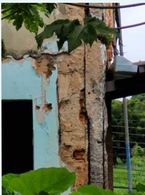
Estruturas comprometidas do imóvel da Copasa em Pedro Leopoldo
